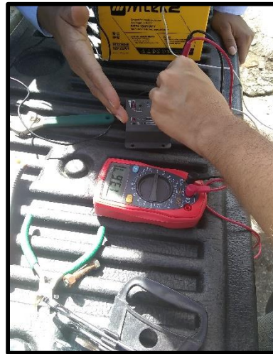
figura 25: Prueba de la Batería
