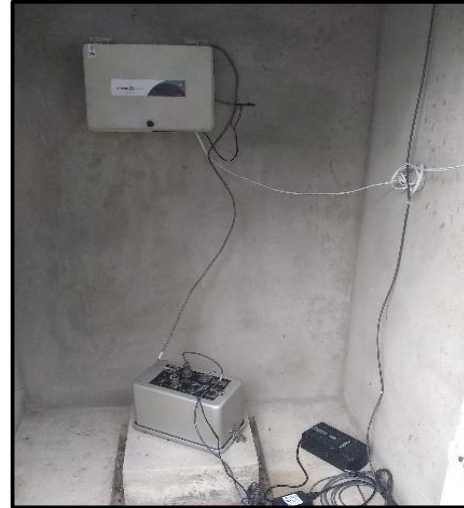
figura 28: conexión de los equipos electrónicos
