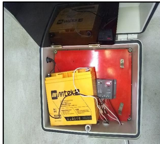
Figura 29: Caja de protección
