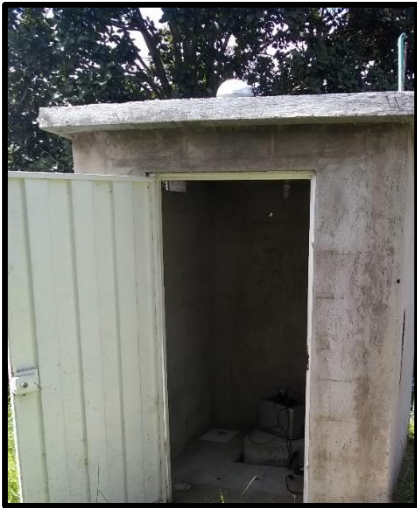
Figura 21: Caseta sin Mantenimiento
